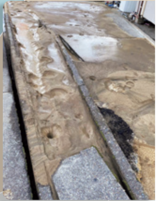
液状化した道路
