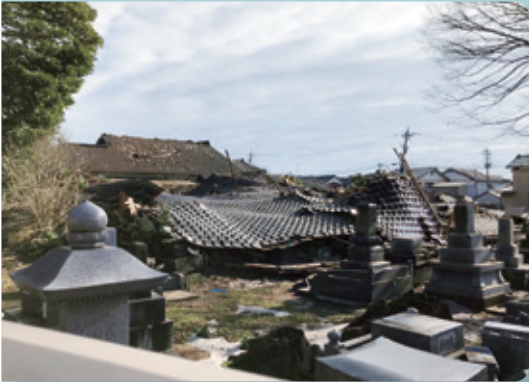
倒壊した本堂
