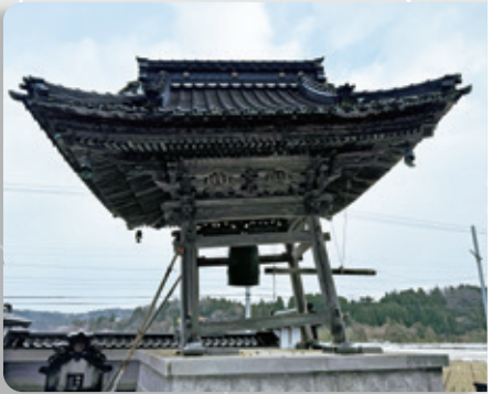
土台がずれた鐘楼
