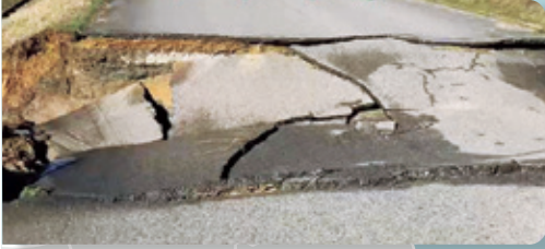
陥没した道路
