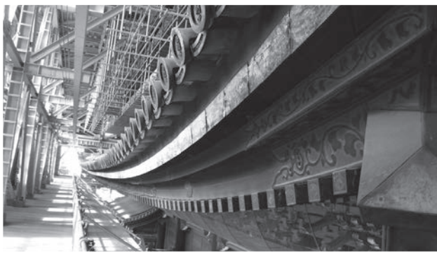
阿弥陀堂のきれいに湾曲している軒先(修復前)
